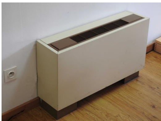
Aérotherme alimenté par le chauffage central eau chaude
